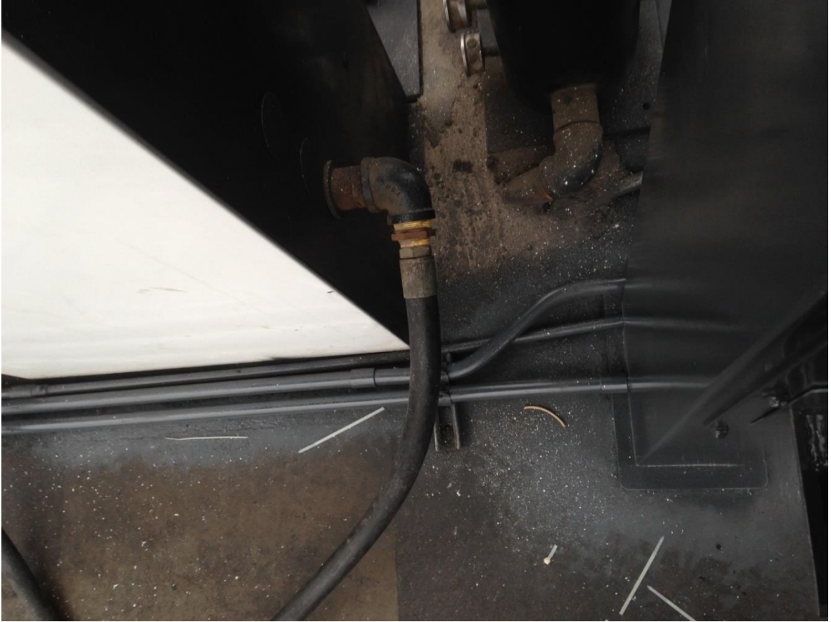
Anexo 4- Foto: Conexiones eléctricas hacia el equipo.
