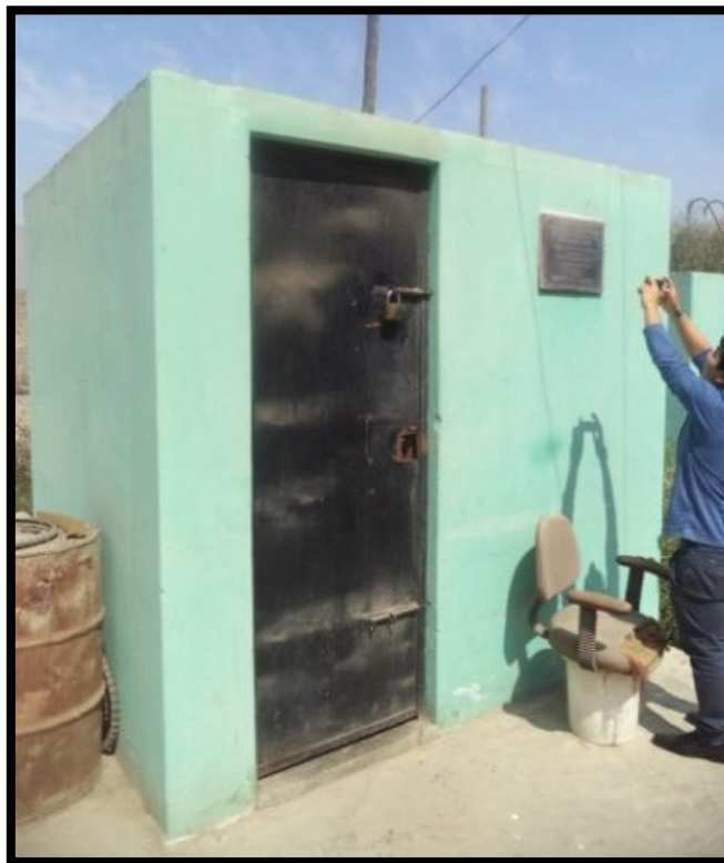
Figura 38. Caseta de bombeo de la planta de tratamiento.
