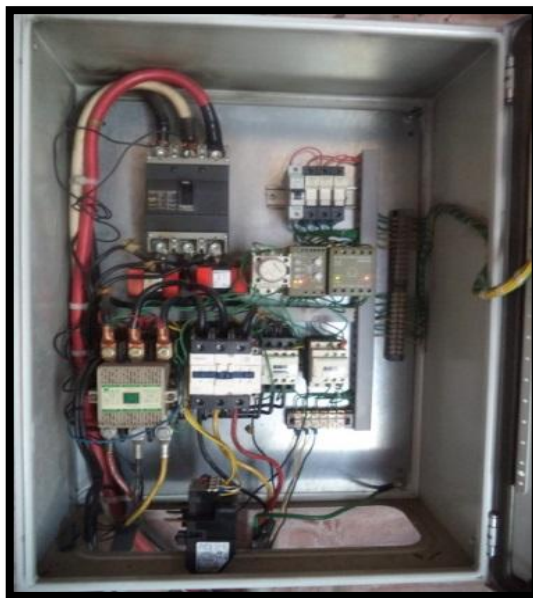
Figura 36. Tablero de arranque existente en el pozo subterráneo.
