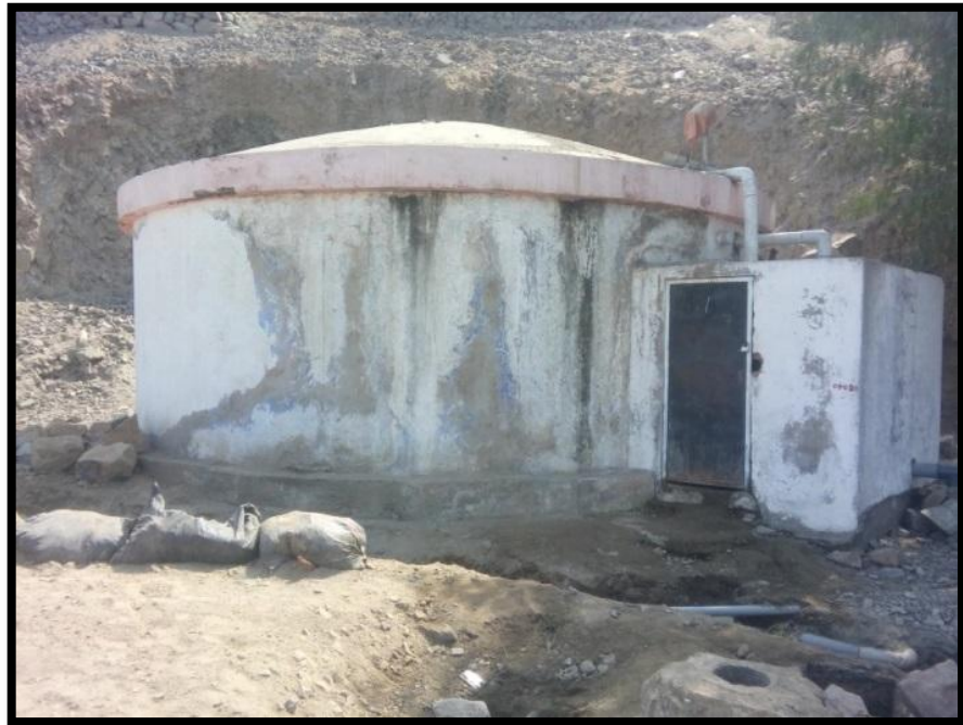
Figura 42. Reservorio final, ubicado en la parte alta de Yanacoto.
