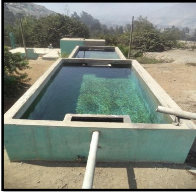
Figura 39. Reservorios de acopio de 50 m 3 cada uno.
