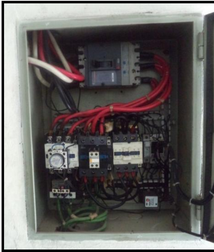
Figura 40. Tablero eléctrico para el arranque del motor sumergible de la planta de tratamiento.
