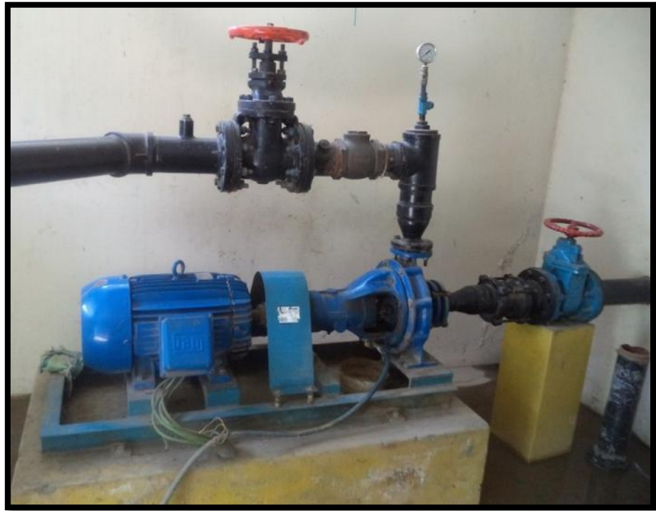
Figura 41. Bomba Centrífuga de respaldo, en la planta de tratamiento.
