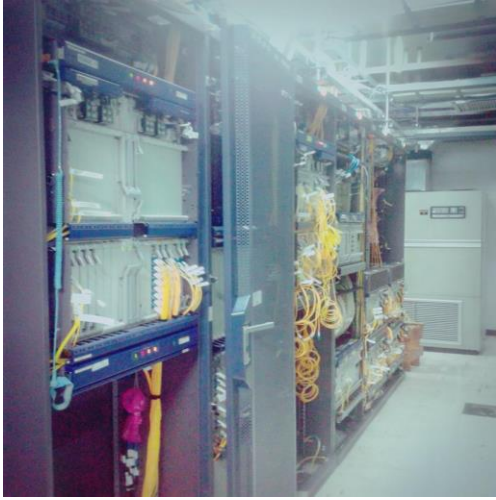
Figura A.4. Data Center Miraflores. Fuente: Elaboración Propia.
