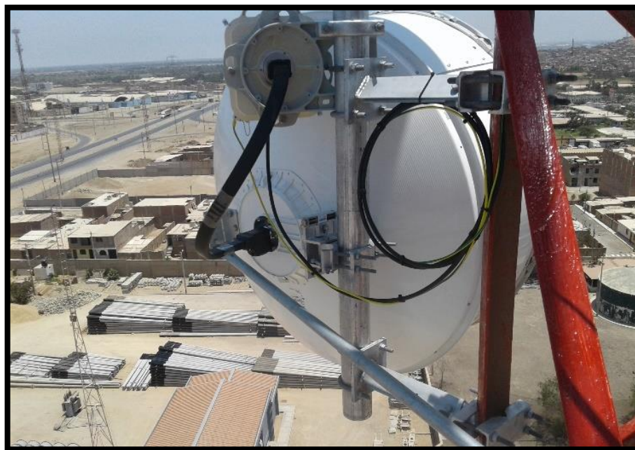
Figura 3.31. Antena instalada y orientada hacia ATC Sapame.
