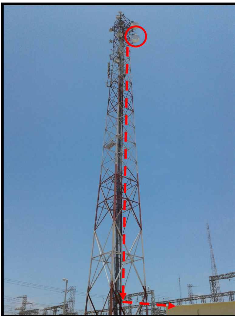
Figura 3.32. Antena instalada en la torre de ITX Chiclayo.
