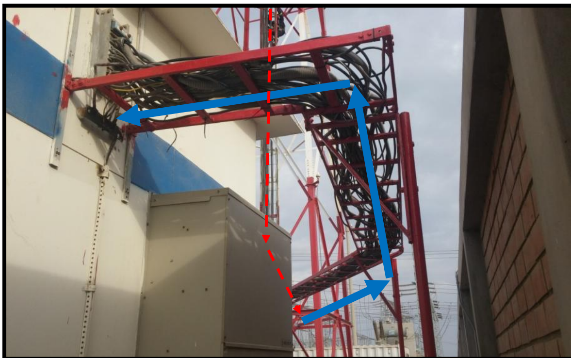
Figura 3.12. Cableado que ingresa al cuarto de comunicaciones.
