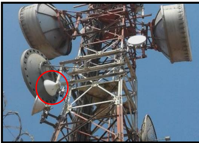
Figura 3.45. Antena instalada en la torre de JAYANCA.
