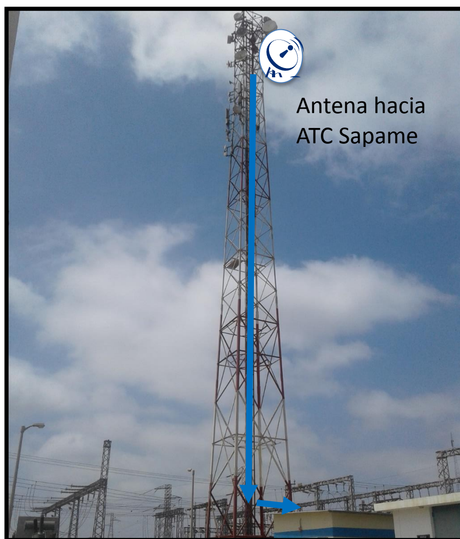
Figura 3.11. Torre de 45 m propiedad de INTERNEXA.
