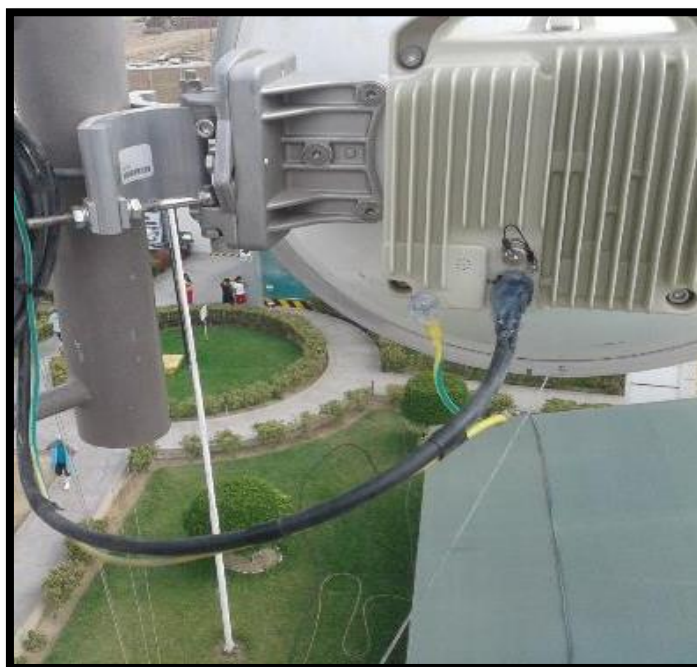
Figura 3.38. Antena instalada y orientada hacia ATC Sapame.
