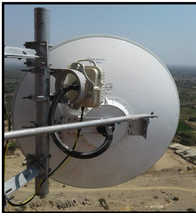
Figura 3.24. Antena instalada y orientada hacia ITX Chiclayo.
