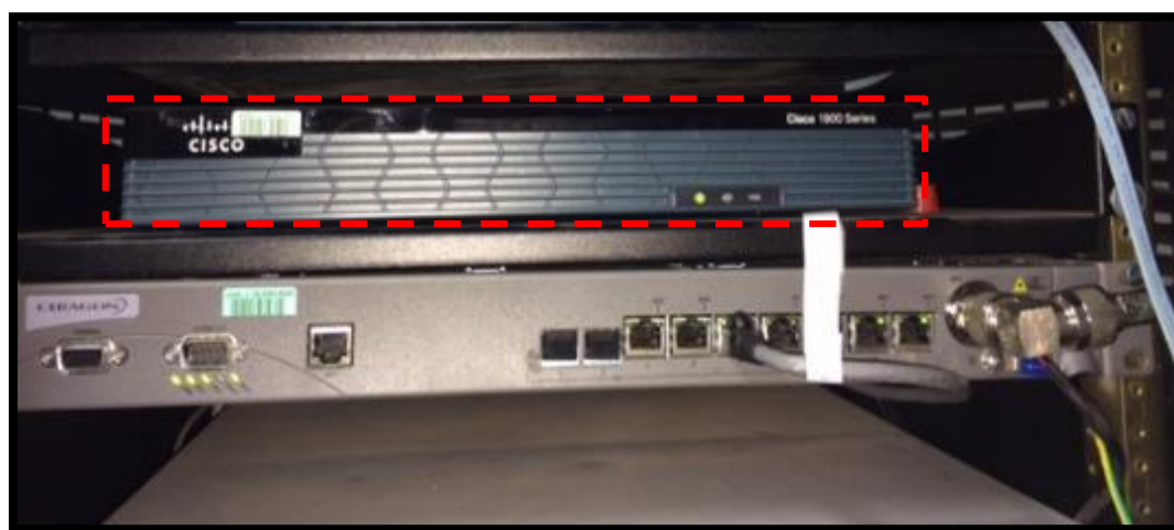
Figura 3.51. Router Cisco 1921 e IDU Ceragon en JAYANCA.
