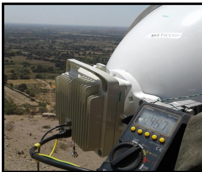
Figura 3.44. Antena instalada y orientada hacia ATC Sapame.
