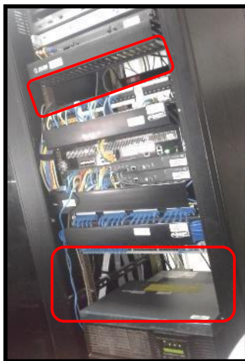
Figura 3.21. Gabinete de comunicaciones de JAYANCA.
