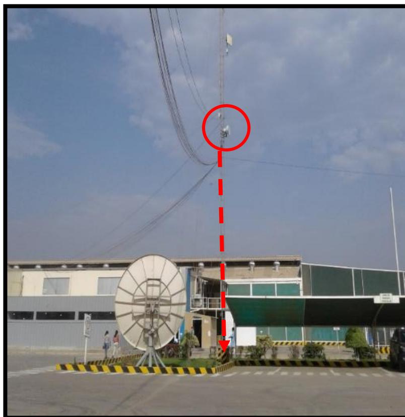
Figura 3.39. Antena instalada en la torre de JAYANCA.
