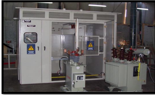
Figura 5: Subestación compacta tipo SCE
