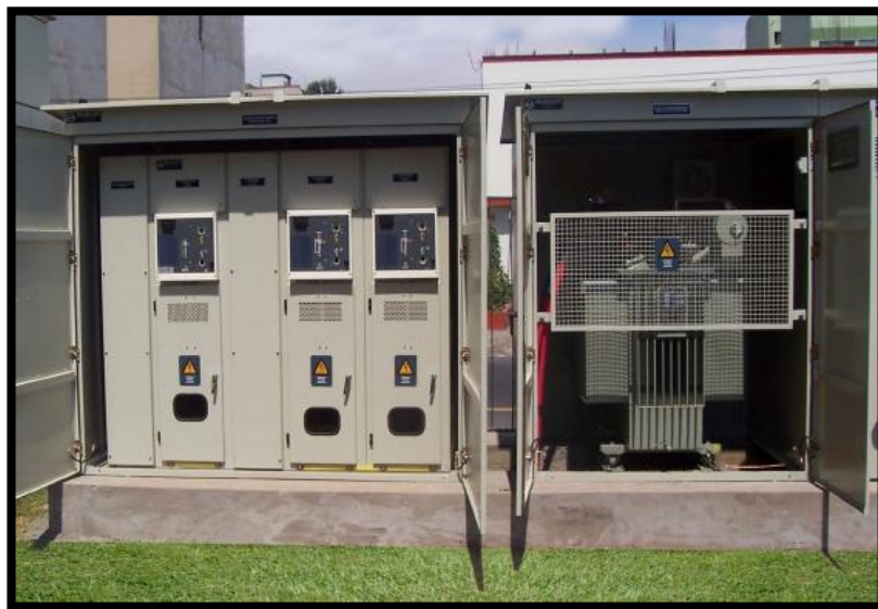
Figura 8: Subestación tipo SMO
