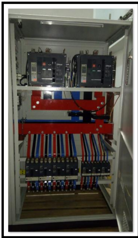
Figura 15: Tablero de transferencia, Gabinete autosportado
