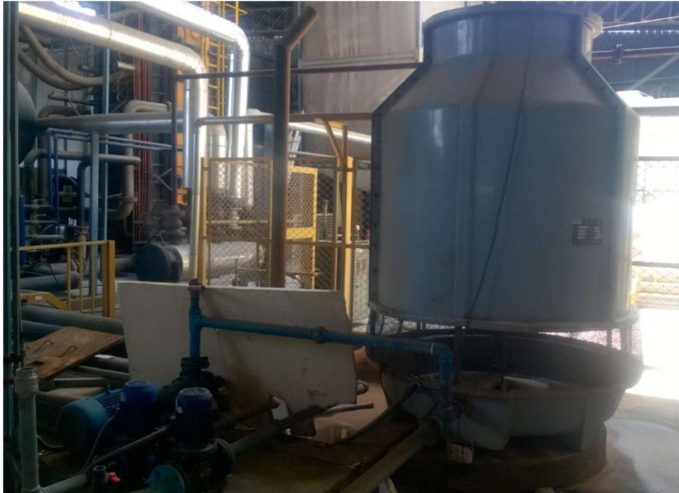
Figura 06. Torre de enfriamiento
