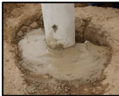
Figura 30: Poste con base de cemento
