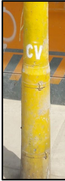
Figura 24: Poste CV Fuente: en campo
