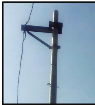
Figura 9: poste con ménsula Fuente: en campo.
