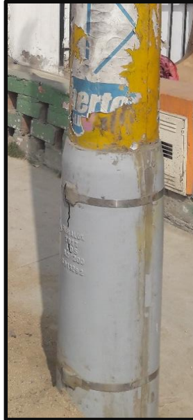
Figura 26: Poste CV Fuente: en campo
