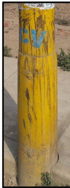
Figura 25: Poste C V Fuente: en campo
