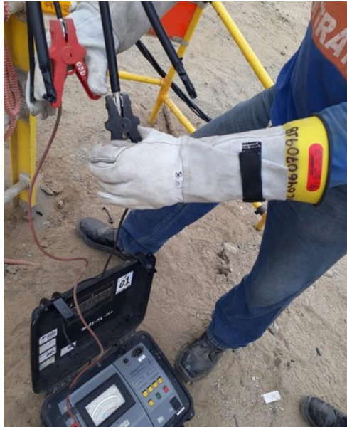
Figura 20. Megado de cables.
