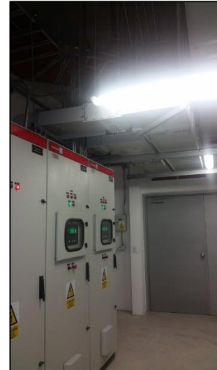
D.B. hacia tablero
