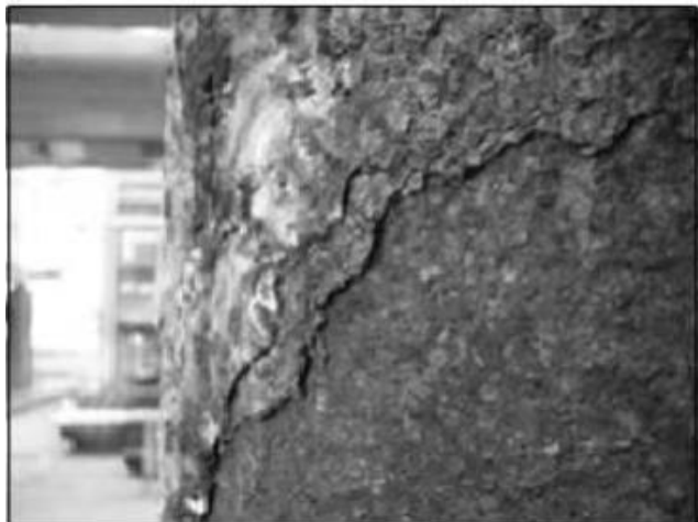
Figura 3.3 Corrosión Bajo Aislación [7]
