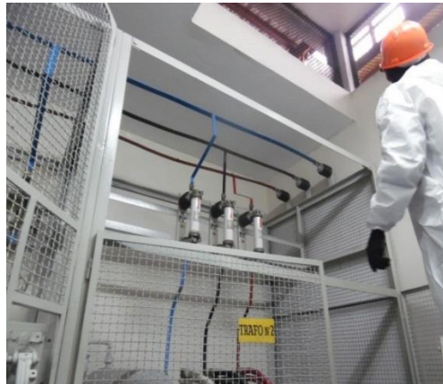
Limpieza de barras, aisladores y pintado de tren de barras de acuerdo al CNE.
