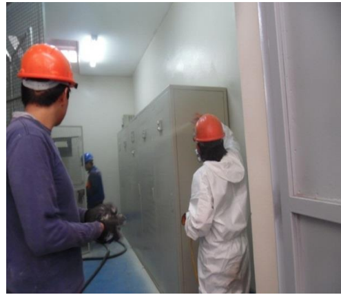
Pintado de tableros de Baja tensión con pintura gloos ral 7032 de sub-estación CHUCUITO 1.
