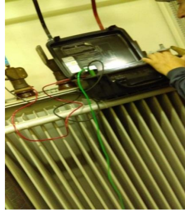
Megado de transformador de 640 KVA, con equipo Megometro de 15 KVi.
