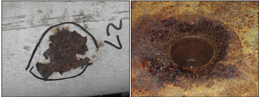
Fig. 2.1 Corrosión Externa e Interna
