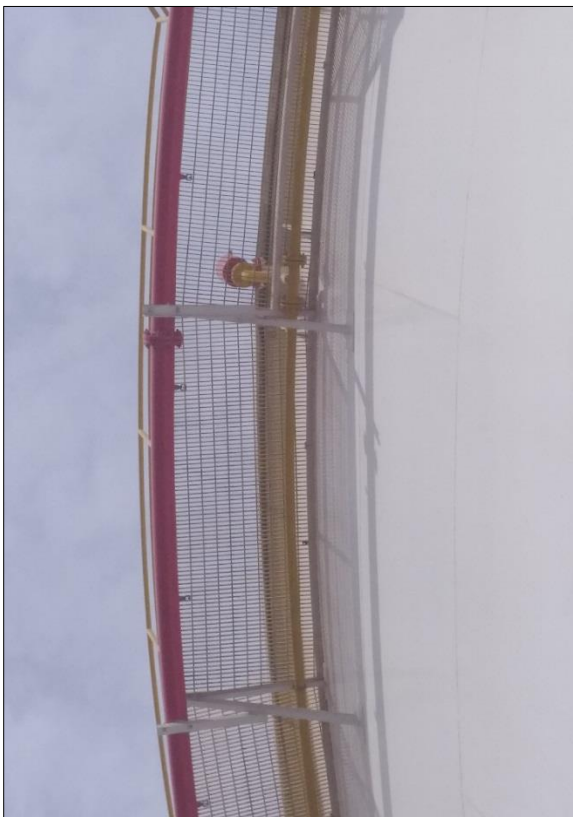
Figura 15: Vista inferior de aspersores instalados
