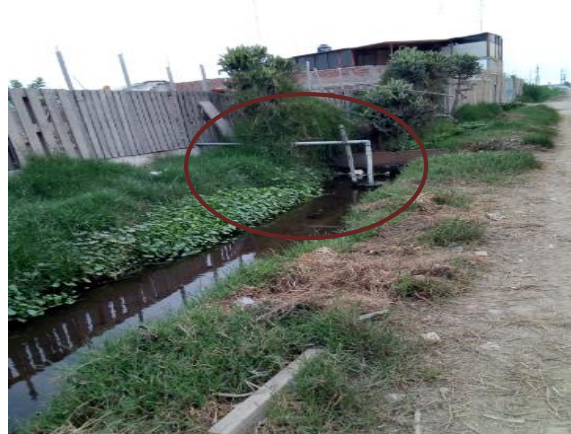
En el recorrido del canal se evidencio bombas de agua.
