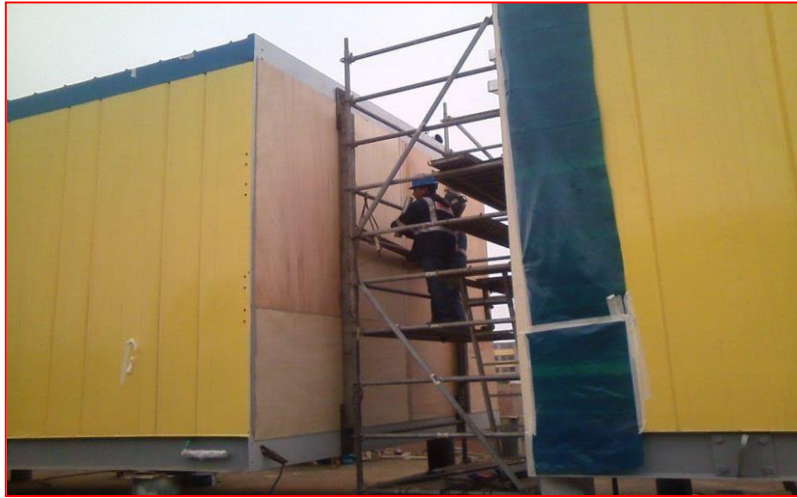
Figura 3.5.1: instalación de pared incorrecta
