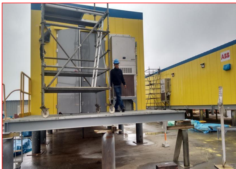
Figura 3.6.1: instalación de Cielo Raso incorrecto
