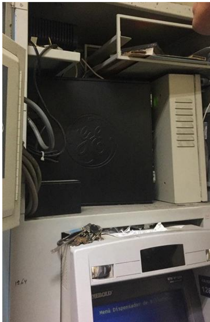
Figura 53. Instalación del módulo emisor y adquisición de datos en el gabinete del cajero Automático del BBVA Continental.
