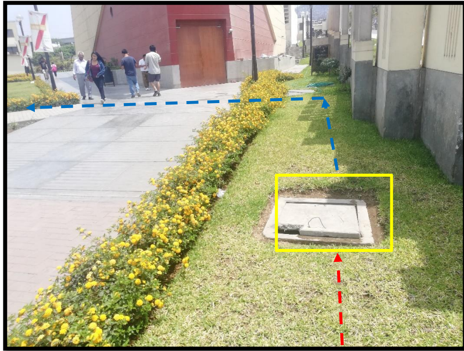
Figura 3.27 Fibra óptica llegó a buzón donde no tiene continuidad con el siguiente y se proyectó canalizado, donde la flecha color azul es canalizado y rojo es el recorrido de la fibra
