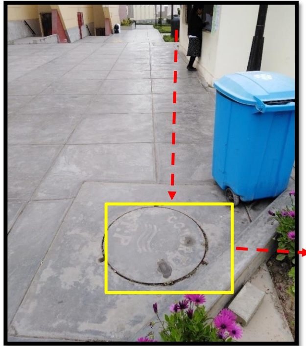
Figura 3.30 Fibra óptica llegó a buzón número 6 por canalizado existente Fuente: Proveedor de internet, 2019
