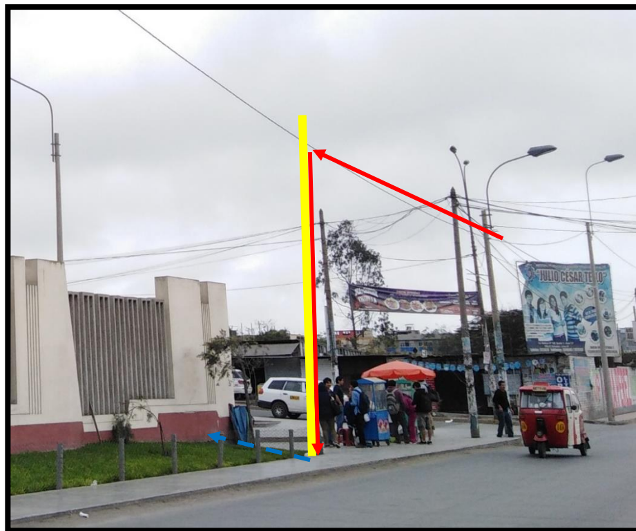
Figura 3.23 Fibra óptica llega a poste de proveedor de internet y desciende por sifón
