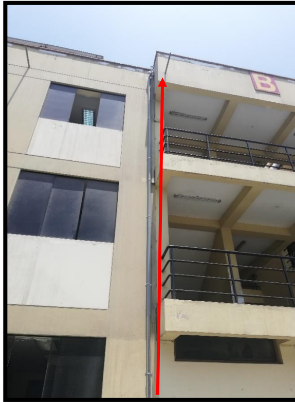
Figura 3.34 Fibra óptica siguió recorrido por tubería Conduit adosada a la pared en el pabellón B de la Universidad Nacional Tecnológica de Lima Sur Fuente: Proveedor de internet, 2019
