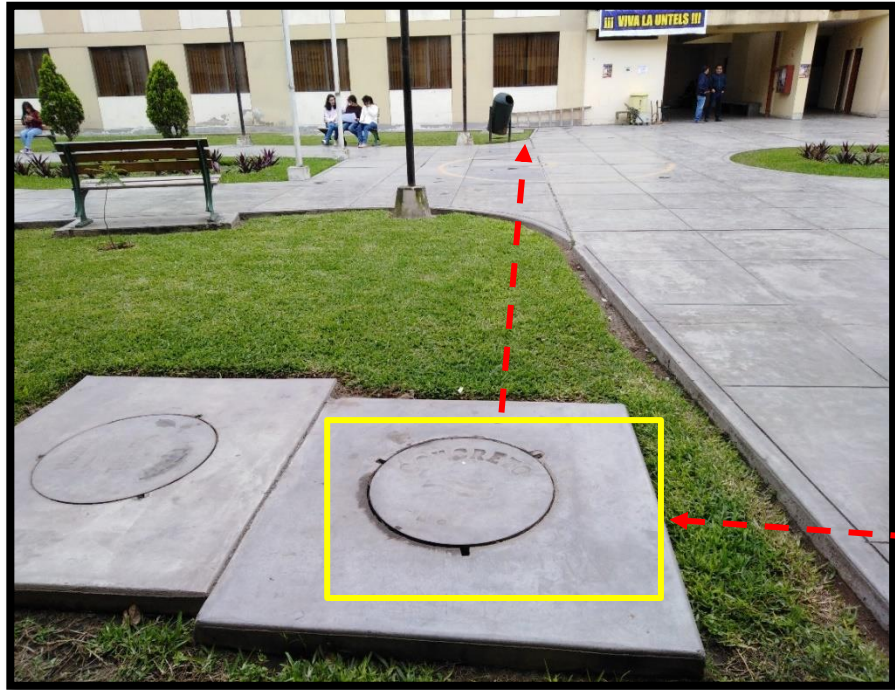
Figura 3.32 Fibra óptica llegó a buzón número 8 por canalizado existente Fuente: Proveedor de internet, 2019
