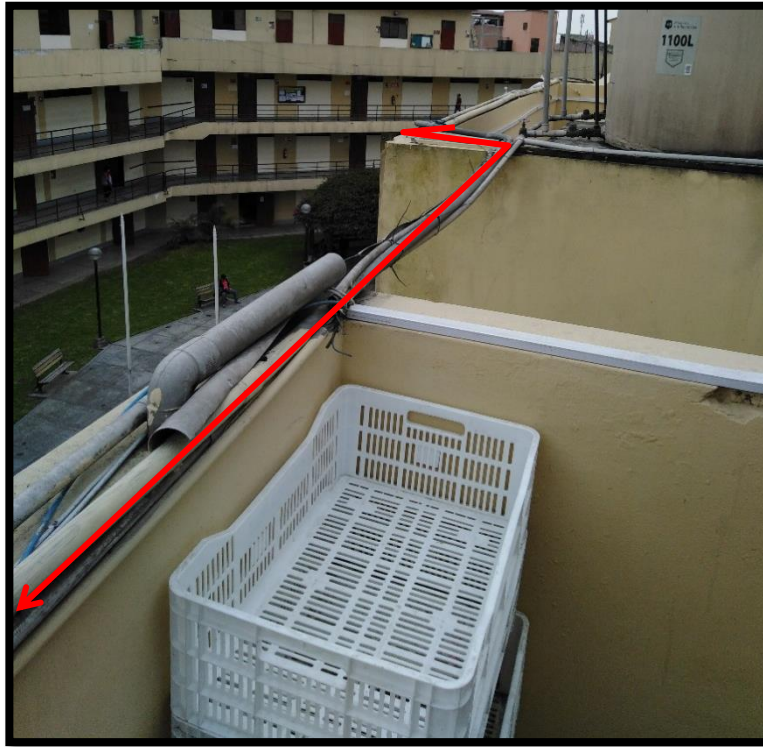
Figura 3.36 Fibra óptica siguió recorrido por tubo PVC en el cuarto piso de la Universidad Nacional Tecnológica de Lima Sur Fuente: Proveedor de internet, 2019
