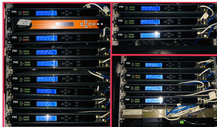
Figura 45: Instalación de Encoder A/V y HDMI Fuente: Elaboración propia
