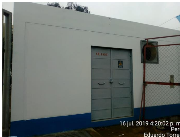
Figura 3: Subestación convencional Fuente: propia
