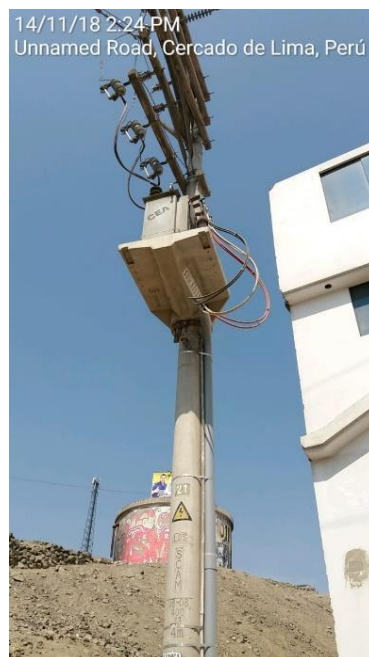
Figura 5: Subestación aérea monoposte Fuente: propia
