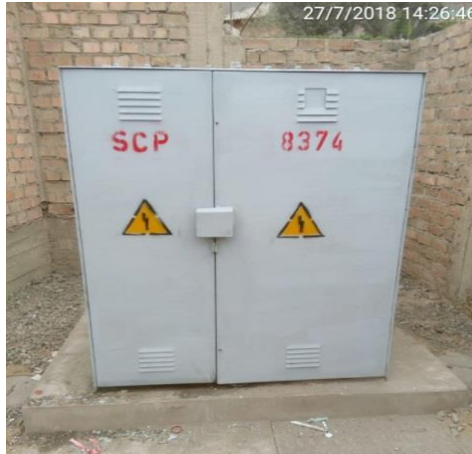
Figura 4: Subestación compacta pedestal Fuente: propia
