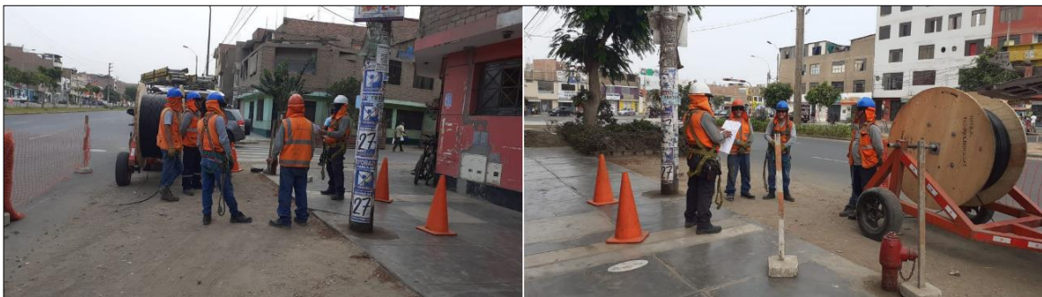
Figura 28. Charla de 5 minutos previo a trabajos de tendido de fibra óptica en PEXT Fuente: Recuperado de Optical Networks, 2020
