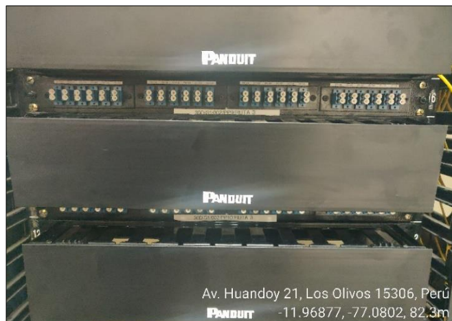
Figura 37. ODF's instaladas de ruta 3 de fibra óptica Fuente: Recuperado de Optical Networks, 2020
