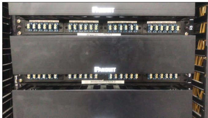
Figura 36. ODF's instaladas de ruta 2 de fibra óptica Fuente: Recuperado de Optical Networks, 2020
