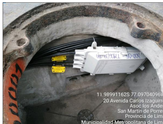
Figura 32. Adecuación de manga mondragón en cámara de telecomunicaciones Fuente: Recuperado de Optical Networks, 2020
