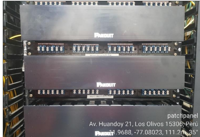
Figura 35. ODF's instaladas de ruta 1 de fibra óptica Fuente: Recuperado de Optical Networks, 2019
