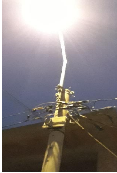
Figura 41. Prueba de encendido de lámparas
