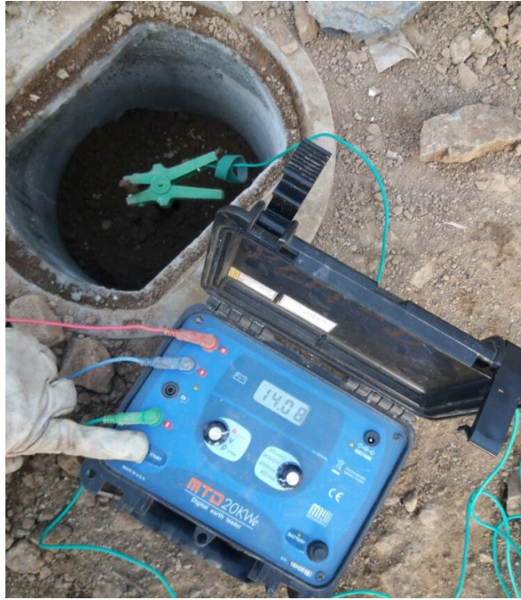
Figura 39. Prueba de resistencia puesta a tierra Fuente: Base de datos de Tecsur S.A
