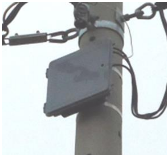
Figura 6. Caja de distribución
