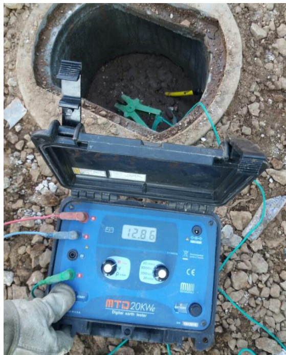
Figura 38. Prueba de resistencia puesta a tierra Fuente: Base de datos de Tecsur S.A
