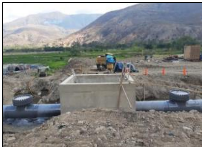
Figura 68: Vista panorámica de los Split tee Fuente: Elaboración propia
