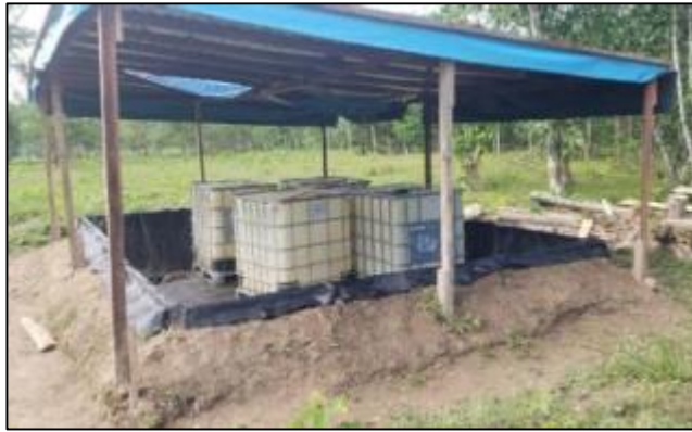
Figura 56: Recipientes de almacenamiento de crudo
