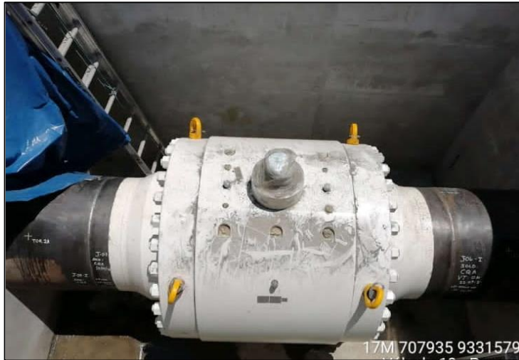
Figura 63: Vista panorámica de la válvula de bloqueo Fuente: Elaboración propia
