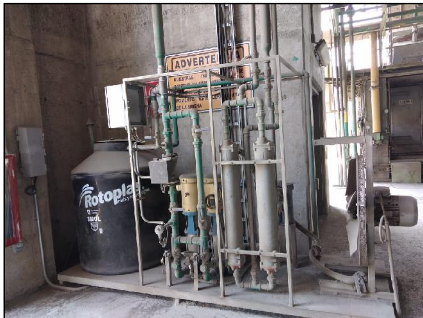
Figura 14. Módulo de sistema de enfriamiento
