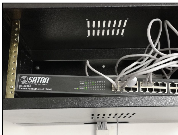
Figura N°5. Estado de los equipos
