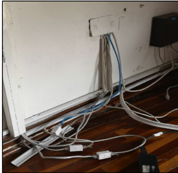
Figura N°4. Estado del cableado
