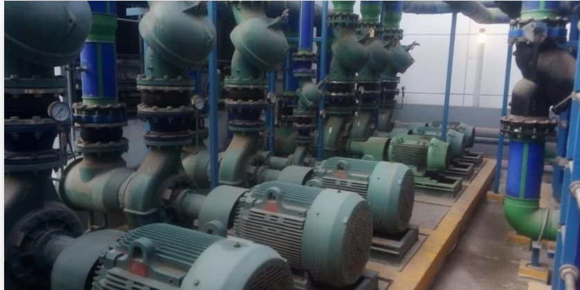
Figura 21. Foto del sistema de enfriamiento 2 del edificio More piso 25
