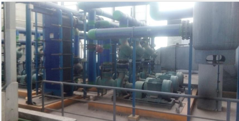
Figura 20. Foto del sistema de enfriamiento 1 del edificio More piso 25
