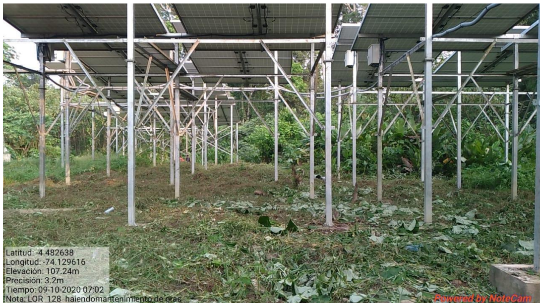
Figura 10. Paneles instalados en el nodo LOR0128. Fuente: Propia.
