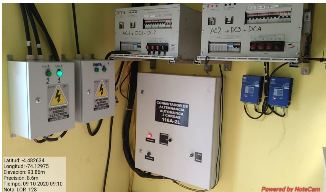
Figura 12. Conexiones en LOR0128. Fuente: Propia
