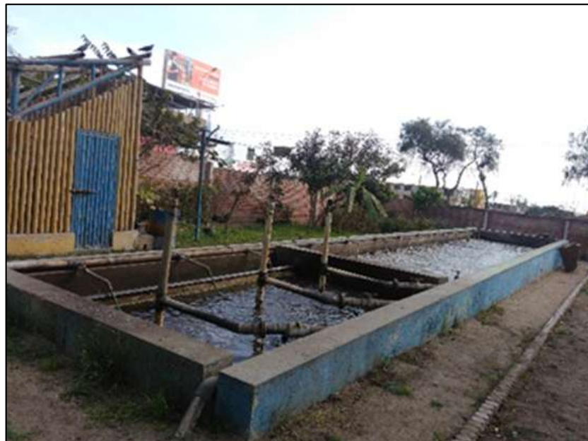
Figura 14. Aguas residuales de la PTAR Juan Velasco Alvarado
