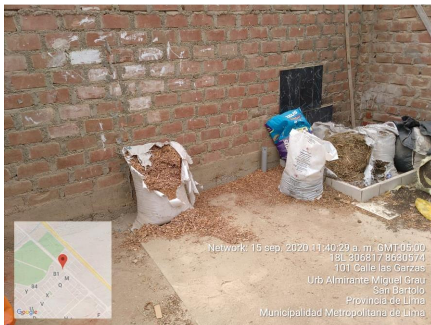
Figura 19. Vista del área inadecuada
