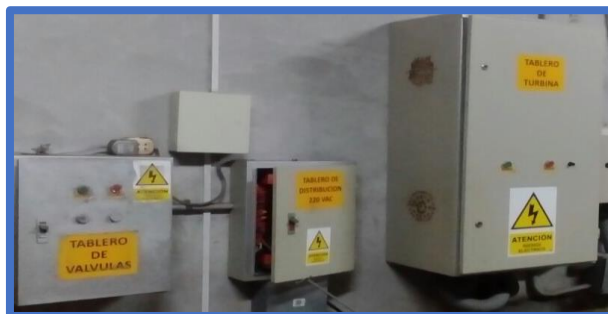
Figura 24. Ubicación de los pulsadores en los tableros. Fuente: (Propia)
