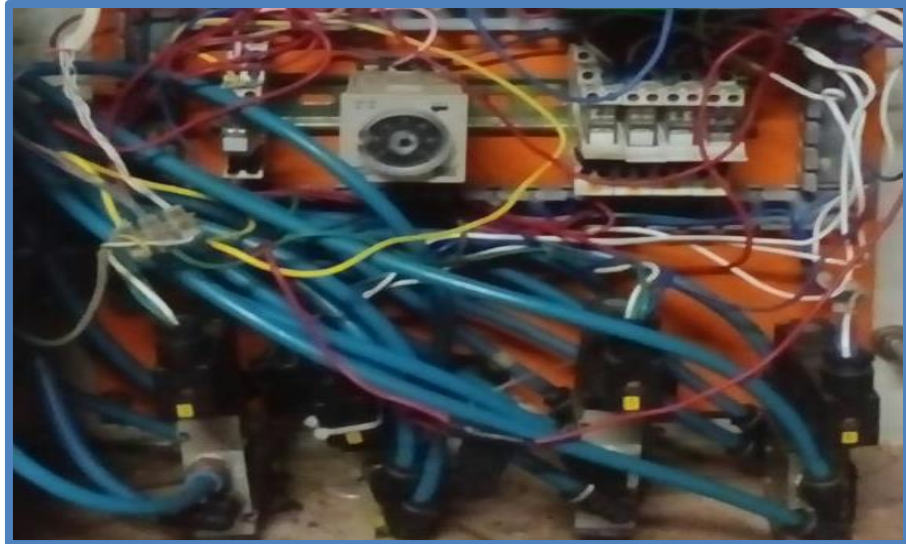
Figura 27. Electroválvulas. Fuente: (Propia).
