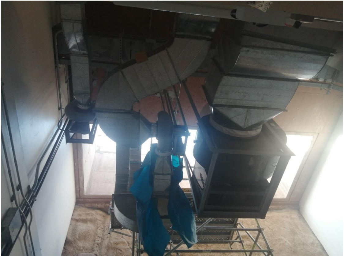
Extractores instalados en área técnica.
