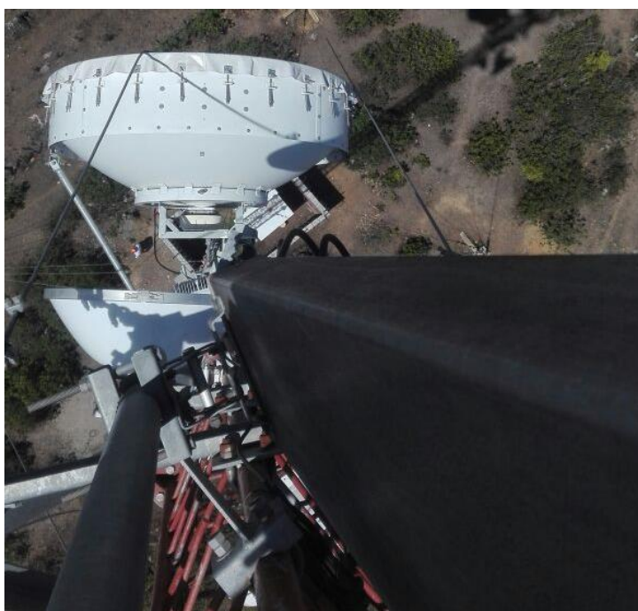
Figura 28 Instalación vista en torre
