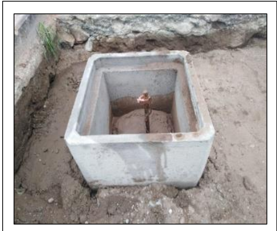
Figura 13 Puesta a tierra (fuente propia)
