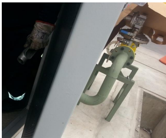
Figura N° 29 – Tren de gas
