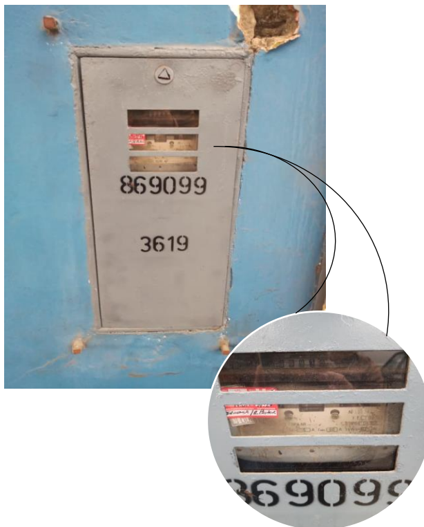
Figura N°20: Caja de suministro de energía – base administrativo
