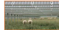
Granja solar de generación
