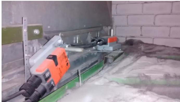
Figura 9. Actuador BELIMO en los ductos de ventilación
