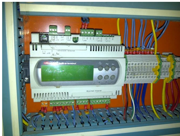
Figura 24. Controlador PCOxs y borneras de conexiones
