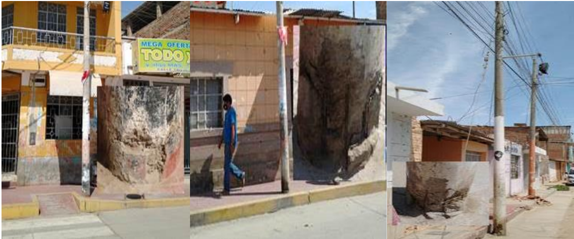
Figura 28 Postes en mal estado y cables en la calle de Imperial.
