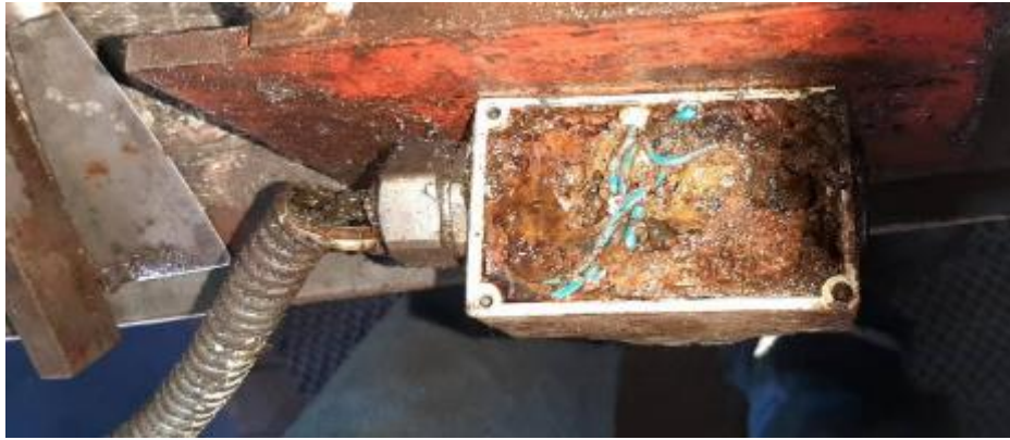
Figura 14. Final de carrera del eje X, con gran cantidad de oxido
