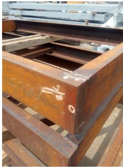
Figura 12. Estructura con oxido excesivo
