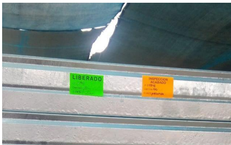
Figura 22. Estructura con etiqueta de liberación por el inspector de calidad
