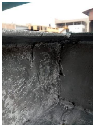
Figura 21. Desprendimiento del recubrimiento de zinc.
