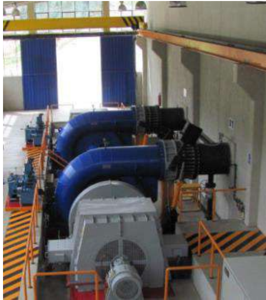
Figura 4: Sistema de Generación Fuente: www.gczingenieros.com/obras_ejecutadas.php?id=21
