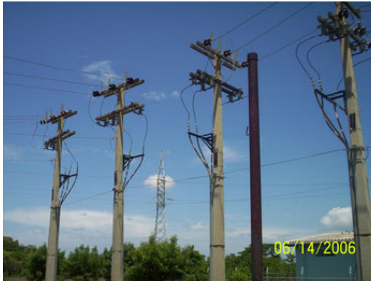
Figura 6: Sistema de Distribución
