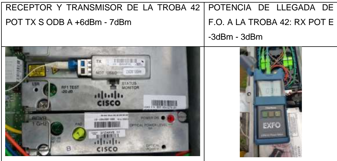
Figura 36: Imagen del receptor y transmisor instalados Trova 42
