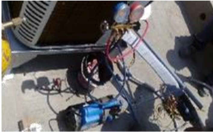
Figura 37. Aplicacion de vacío del equipo de aire de confort de 60000BTU
