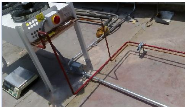
Figura 34. Montaje de Unida Condensadora del Equipo de Aire de Precisión de 3TR.
