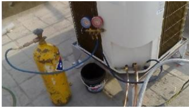
Figura 36. Presurización de equipo de confort de 60000BTU.
