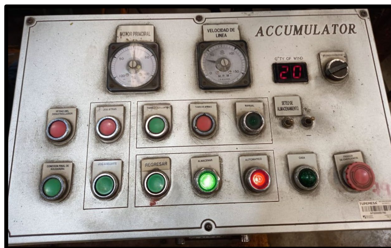
Figura 11: Tablero de control Acumulador
