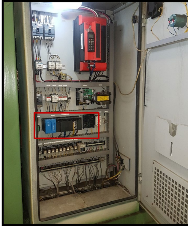
Figura 7: Tablero eléctrico – K200S
