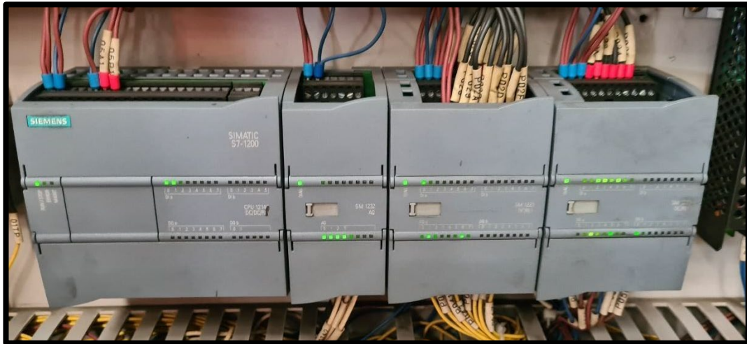
Figura 10: Prueba de encendido PLC S7-1200
