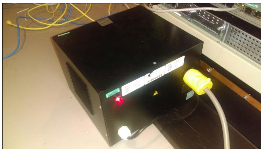
Figura 44. Transformador de aislamiento lado cliente Fuente: Elaboración propia
