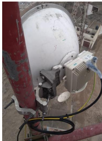
Figura 39. Antena y ODU Ceragon lado nodo Fuente: Elaboración propia
