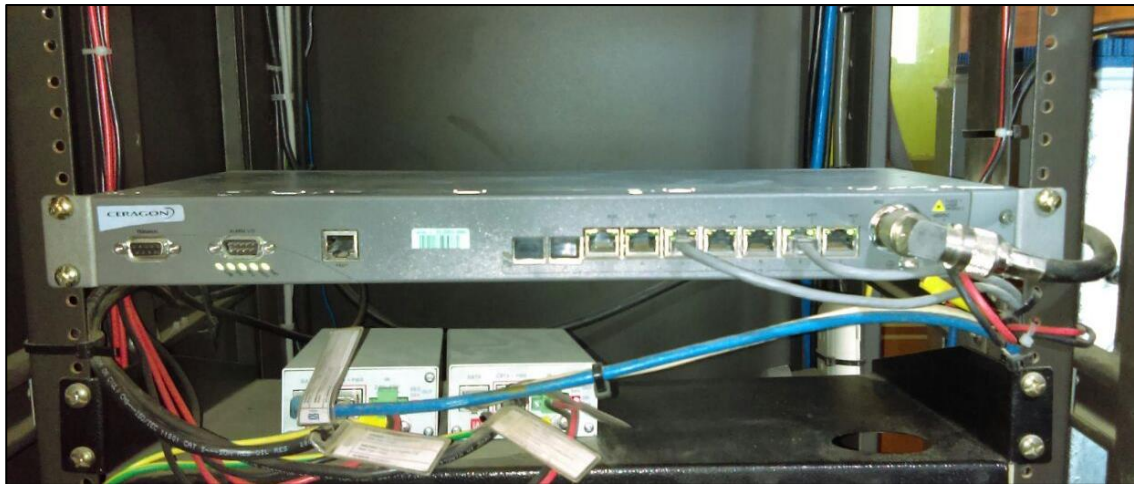
Figura 42. Equipos internos lado cliente Fuente: Elaboración propia
