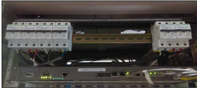
Figura 37. Bastidor de breaker lado nodo Fuente: Elaboración propia
