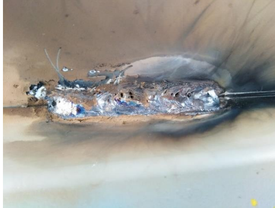
Figura 21. Defecto en el cordón de soldadura
