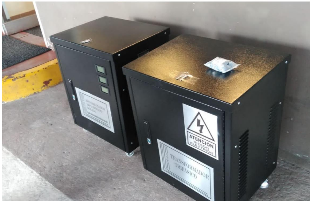
Figura 14 Transformador de aislamiento y Estabilizador de voltaje.
