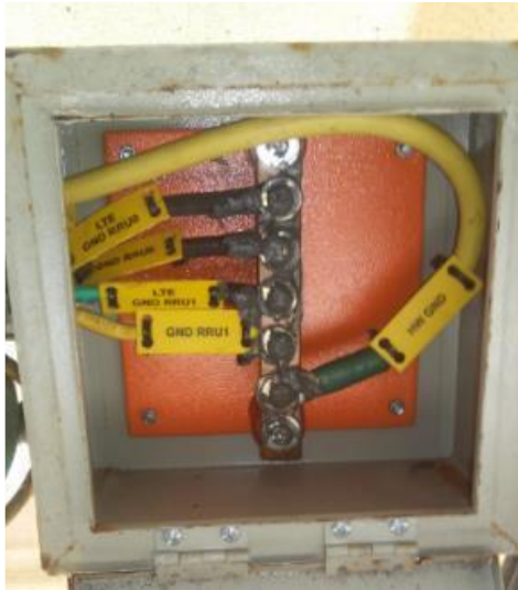
FIGURA 17. Barra de tierra para RRU's.
