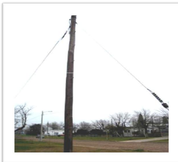
Figura 3.3 “postes para el cableado de fibra óptica”
