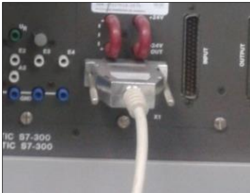
Figura 32. Conexión del mando manual hacia el Controlador Lógico Programable
