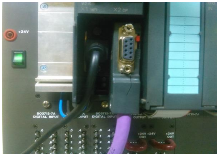
Figura 37. Cable morado de la red PROFIBUS-DP conectado al Controlador Lógico Programable
