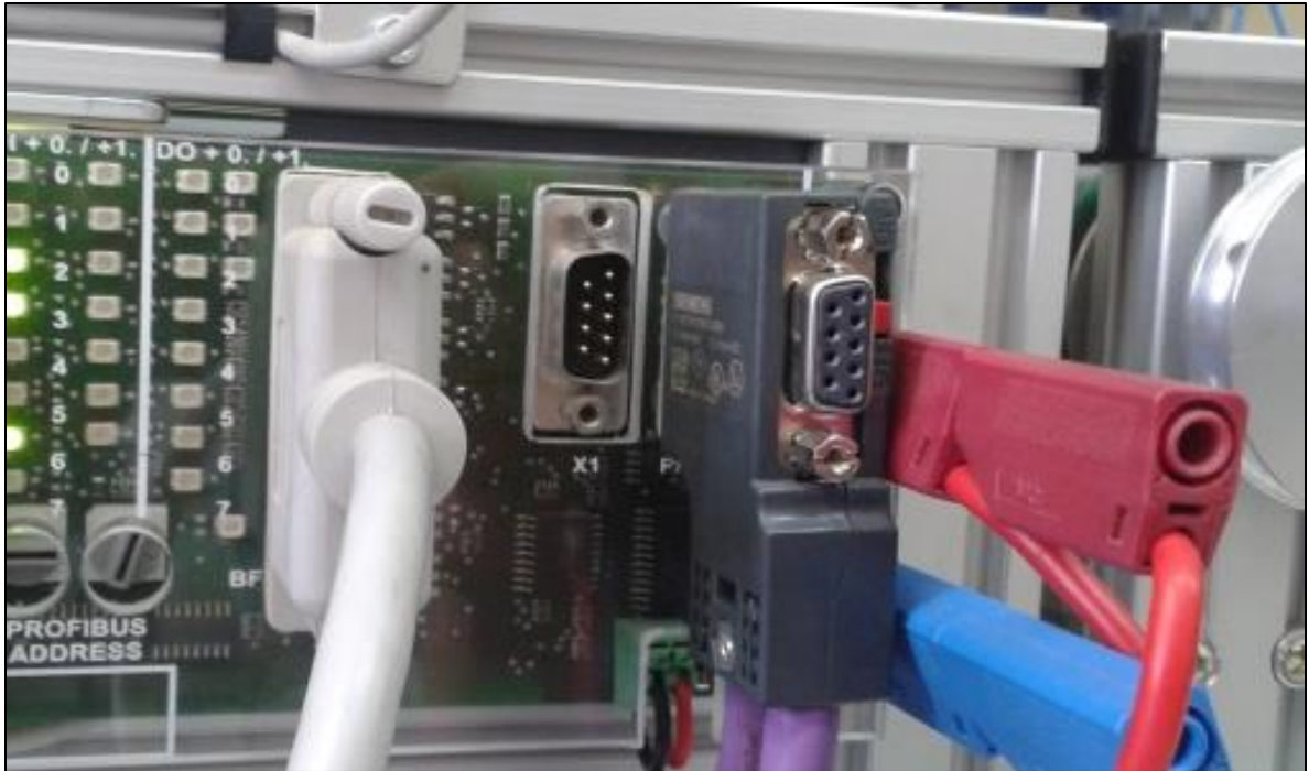
Figura 26. Cable morado DB9 parte de la red PROFIBUS, cables rojo y azul son de la fuente de alimentación
