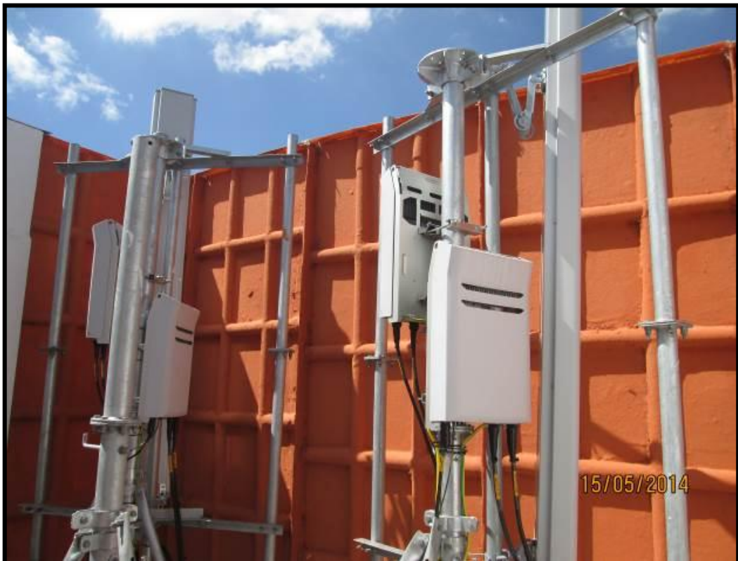
FIGURA N° 3.8: ANTENAS EXISTENTES 2G Y 3G EN ESTACIÓN BASE.
