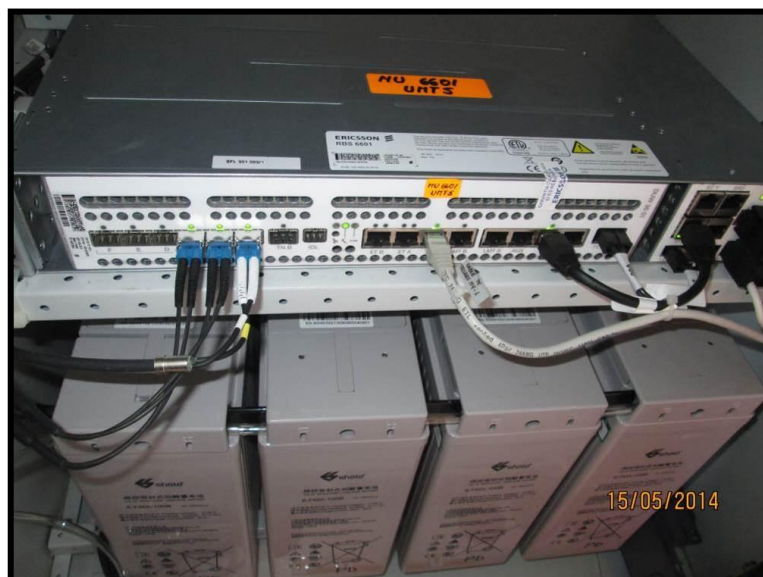
FIGURA N° 3.7: MU 6601 3G EXISTENTE, INSTALADA EN GABINETE HUAWEI.
