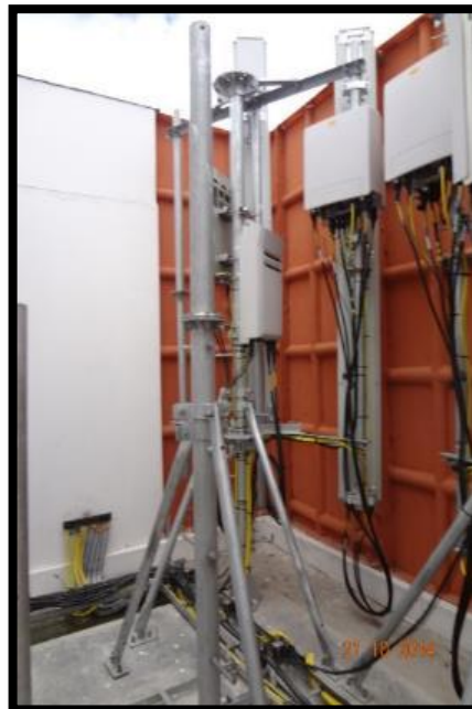
FIGURA N° 3.30: INSTALACIÓN COMPLETA 4G EN MASTIL.
