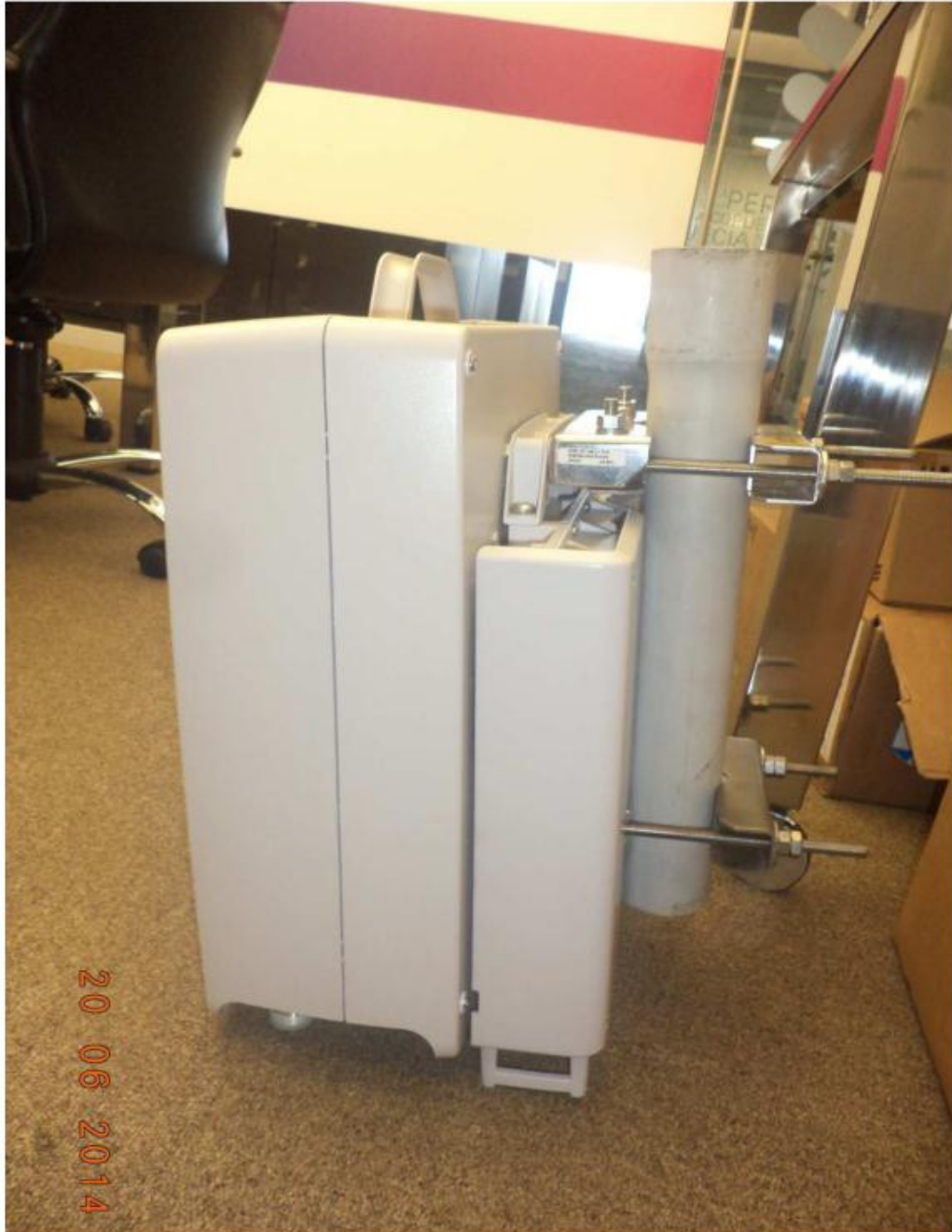
VISTA PANORÁMICA LATERAL DE INSTALACIÓN RRU11 Y RRU A2
