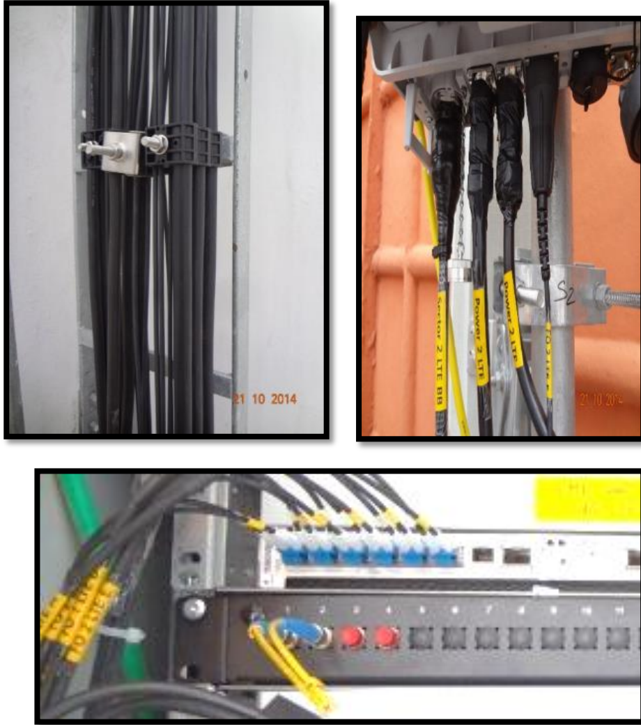
FIGURA N° 3.24: CONEXIÓN Y SUJECIÓN DE LOS CABLES DE F.O Y D.C.
